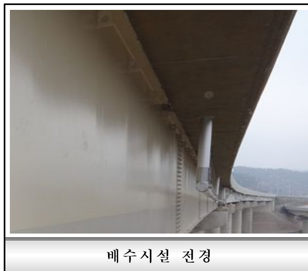
【표 2.1-2】 배수시설 손상물량
